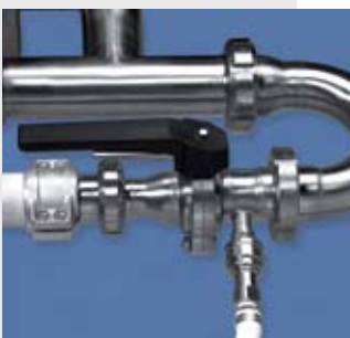
Всасывающий шланг контейнера, подсоединенный к линии CIP
