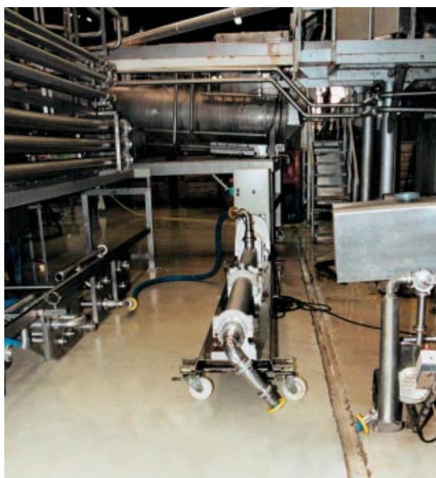
Насос 40N24 на участке переработки фруктов и овощей в процессе подачи фруктового пюре на теплообменник / охладитель
